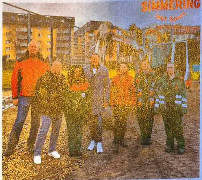
BV Thomas Steinhart und BV-Stv. Ramona Miletic bei den Umbauarbeiten für den neuen Kunstrasen.
